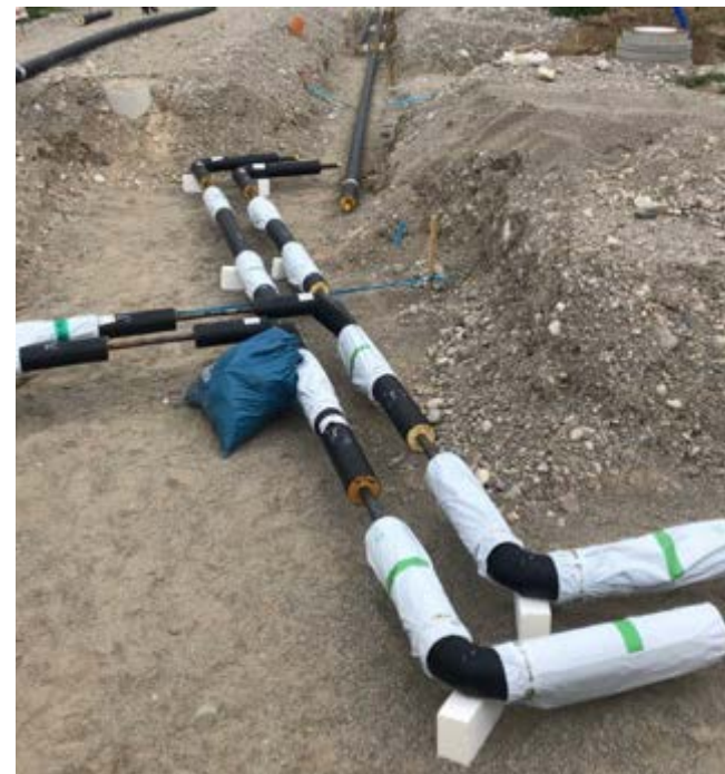
Fernwärmeversorgung im neuen Baugebiet „Stocket“. Die guten Voraussetzungen werden genutzt – jedes Gebäude erhält einen Fernwärmeanschluss.
